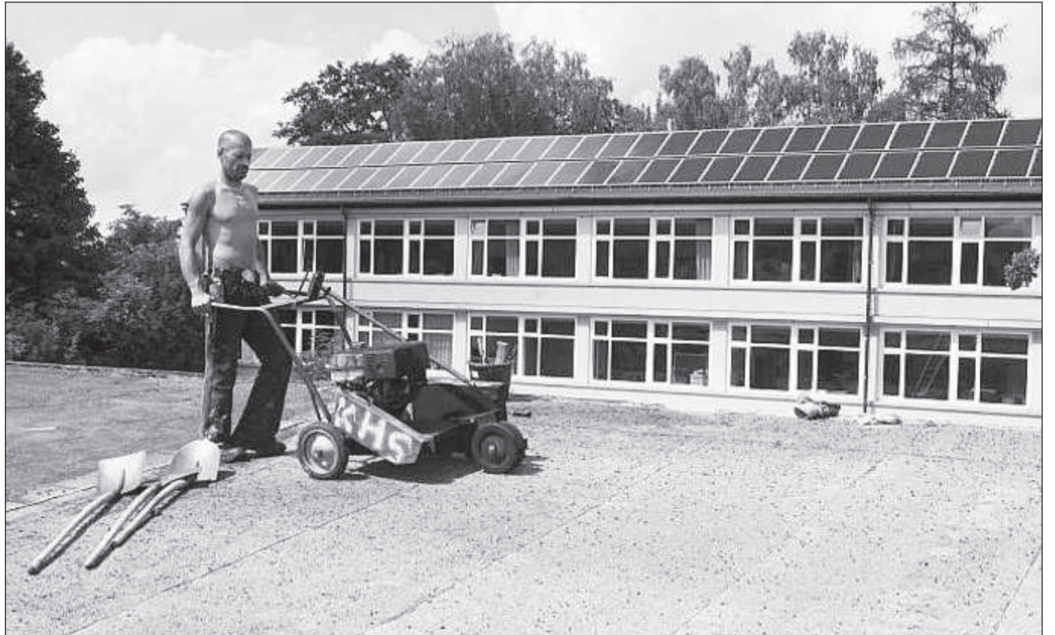
Die Dachdämmung auf dem Pavillon der Römer Haldenschule vor drei Jahren hat sich bezahlt gemacht.
